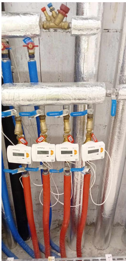
Szacht techniczny z zaworami w pozycji zamkniętej
