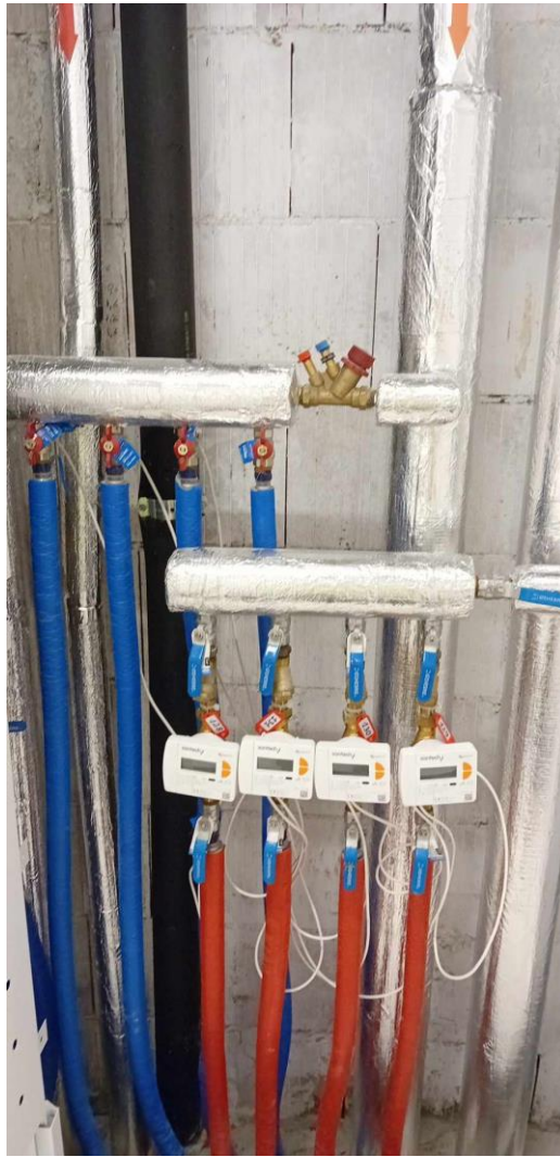
Szacht techniczny z zaworami w pozycji otwartej
