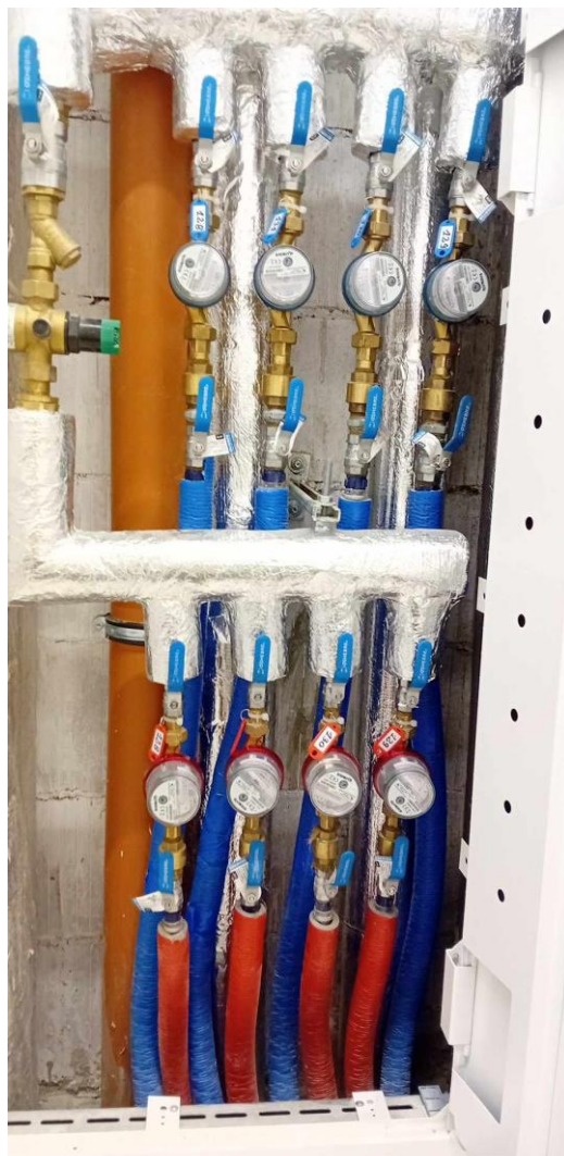
Szacht techniczny z zaworami w pozycji otwartej.
