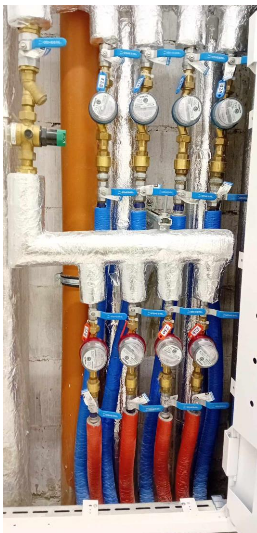
Szacht techniczny z zaworami w pozycji zamkniętej.
